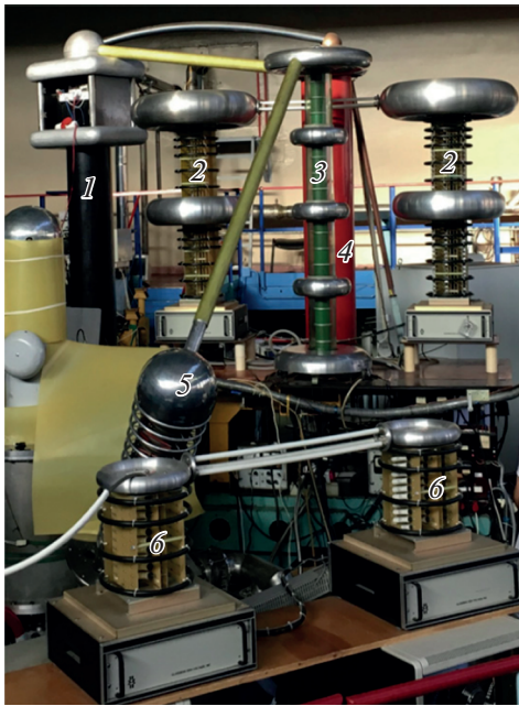
Рис. 3. Высоковольтная система питания диагностики ЗПТИ на токамаке Т-10. 1 — высоковольтная колонна с источником тока для нагрева эмиттера; 2 — источник питания инжектора Glassman (400 кВ); 3 — измерительный делитель напряжения (1 ГОм); 4 — сглаживающий емкостной фильтр; 5 — инжектор; 6 — источник питания энергетического анализатора Glassman (100 кВ).
