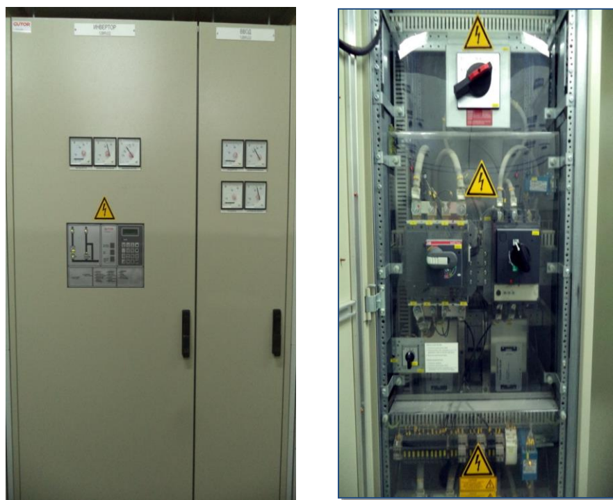
Рис. 7.7 – Общий вид Инверторной установки САЭ.
