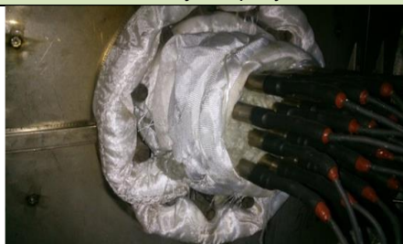
Рисунок 8. Состояние выводов ТЭН КД после реализации мероприятий.
