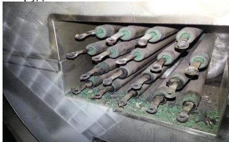
Рисунок 7. Повреждение изоляции выводов ТЭН КД.
