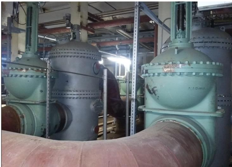
Фильтры системы охлаждающей воды неответственных потребителей
