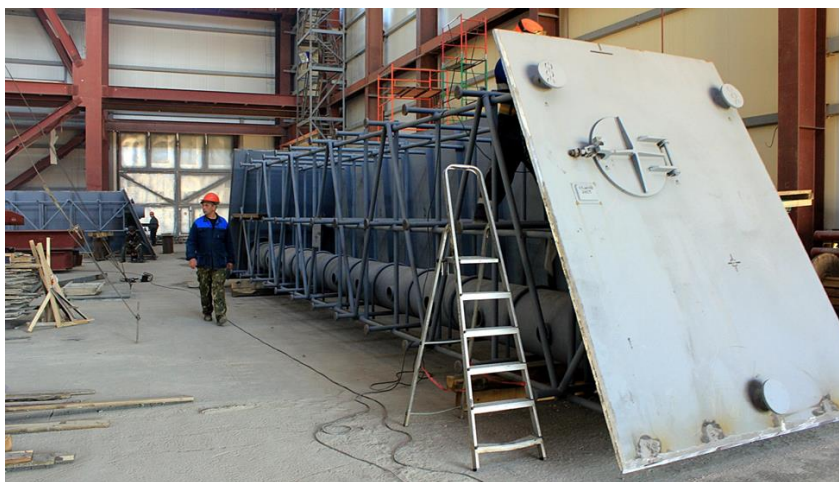
Переходной патрубков конденсатора с паросбросным устройством БРУ-К
