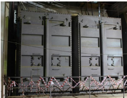
Крышки (створки) водяных камер
