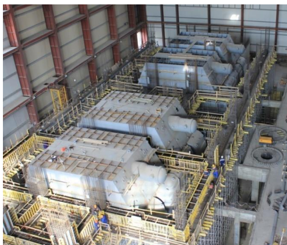
Конденсаторы турбины К-1200-6,6/50
