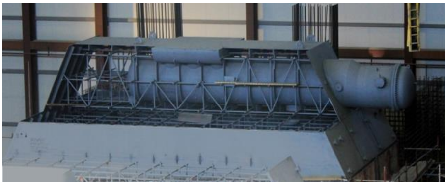
ПНД-1 в переходном патрубке конденсатора
