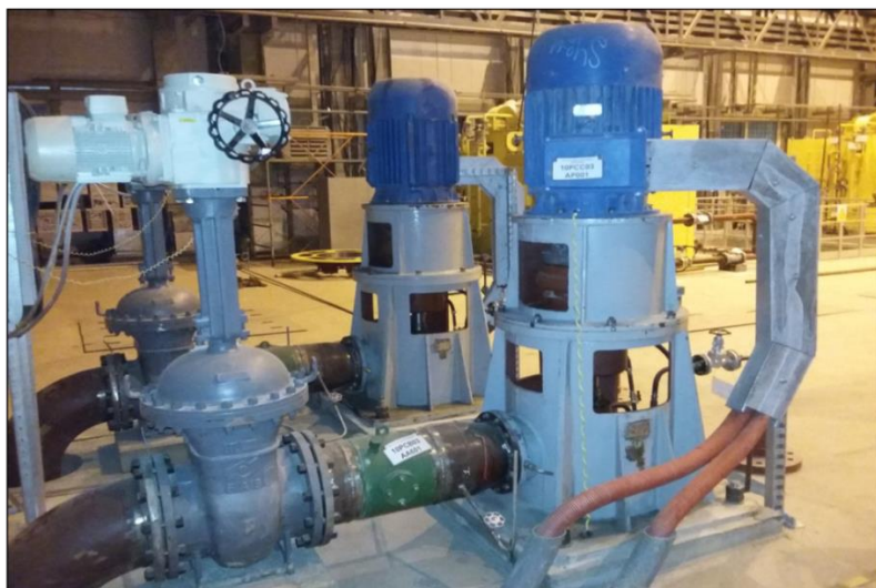
Насос охлаждения теплообменников РДЭС
